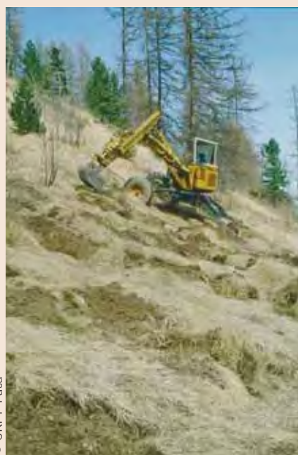
Sur pente forte (jusqu'à 60 %), l'ouverture de potets se fait au godet de 50 litres monté sur pelle araignée.
